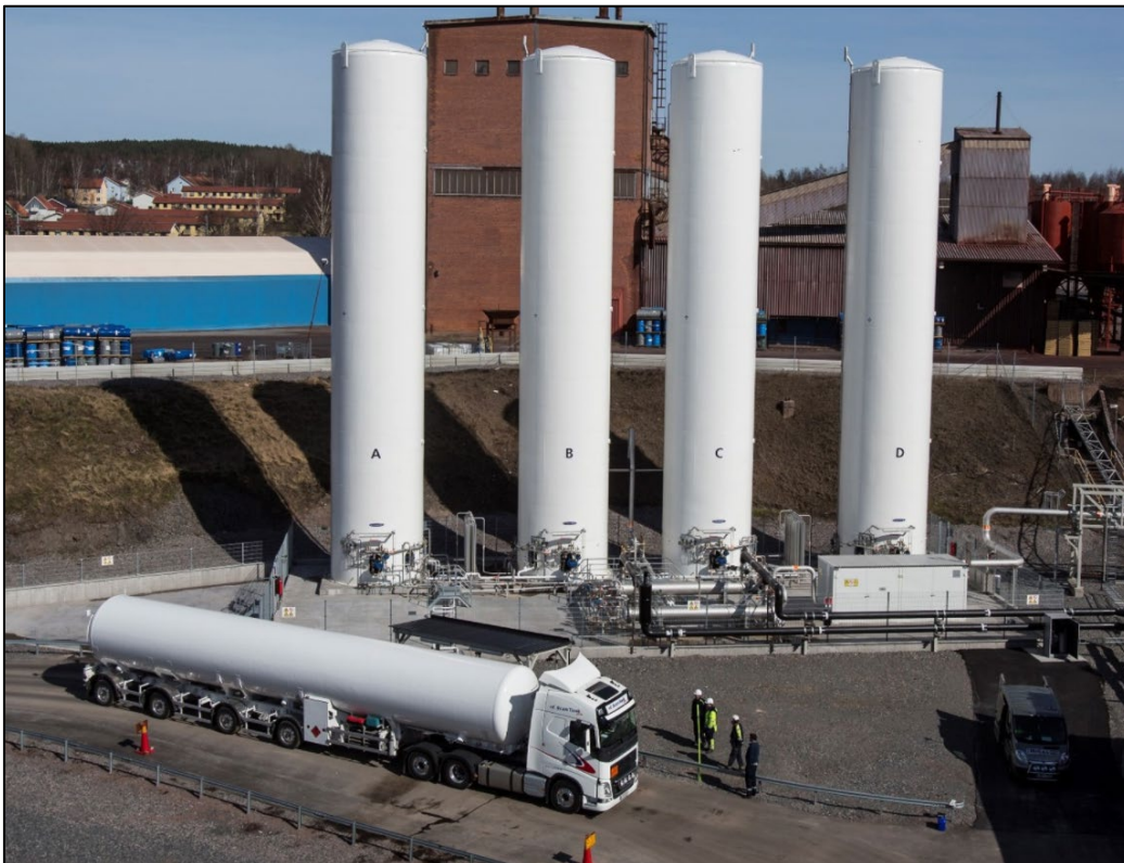
Figur 8. Principskiss av anläggning med vertikal lagring. Exempelbilden från SSABs anläggning i Borlänge.
